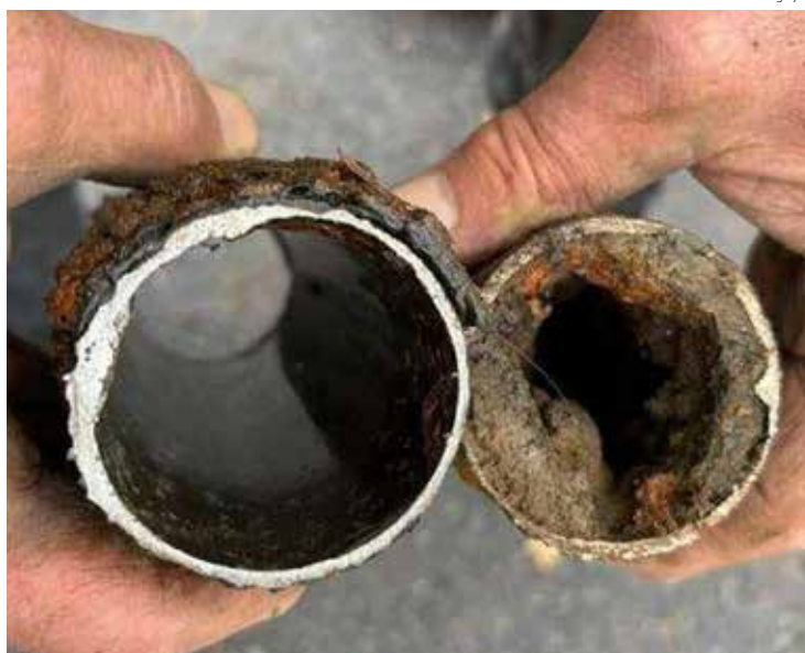
Comparativo entre uma tubulação preservada e outra severamente deteriorada pela corrosão
