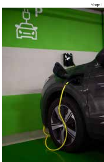
A questão da implantação de pontos de carregamento de veículos elétricos no condomínio passa pela apresentação de um projeto técnico
