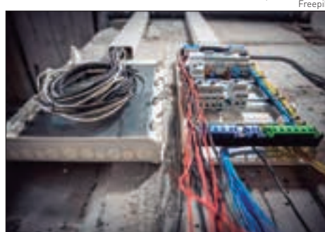
Escolha dos cabos é fundamental para garantir a segurança nos condomínios
