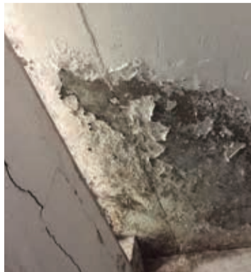
Inspeção predial identificará patologias e dará um direcionamento de manutenção para os condôminos
